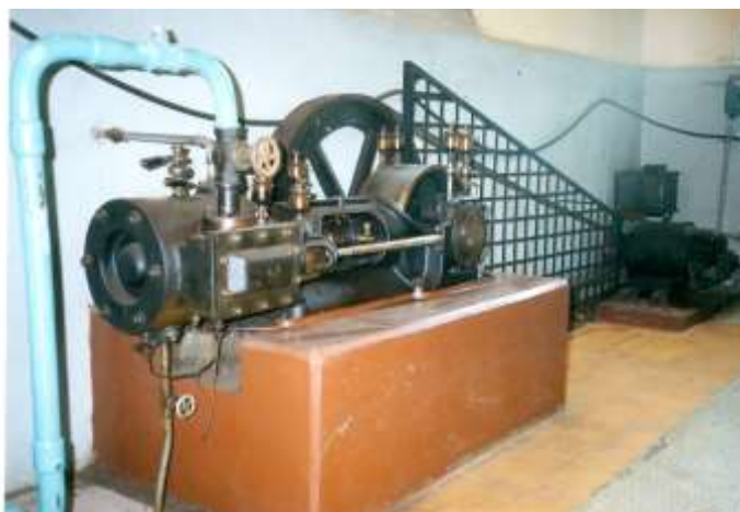
Původní vývěva v čerpací stanici (foto 1995)
