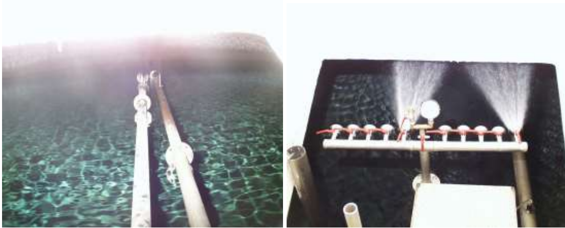
Původní rozváděcí potrubí ze žlaby v zadní části a rozstřikovací růžice VDJ Ještěrka 1 (2004)
